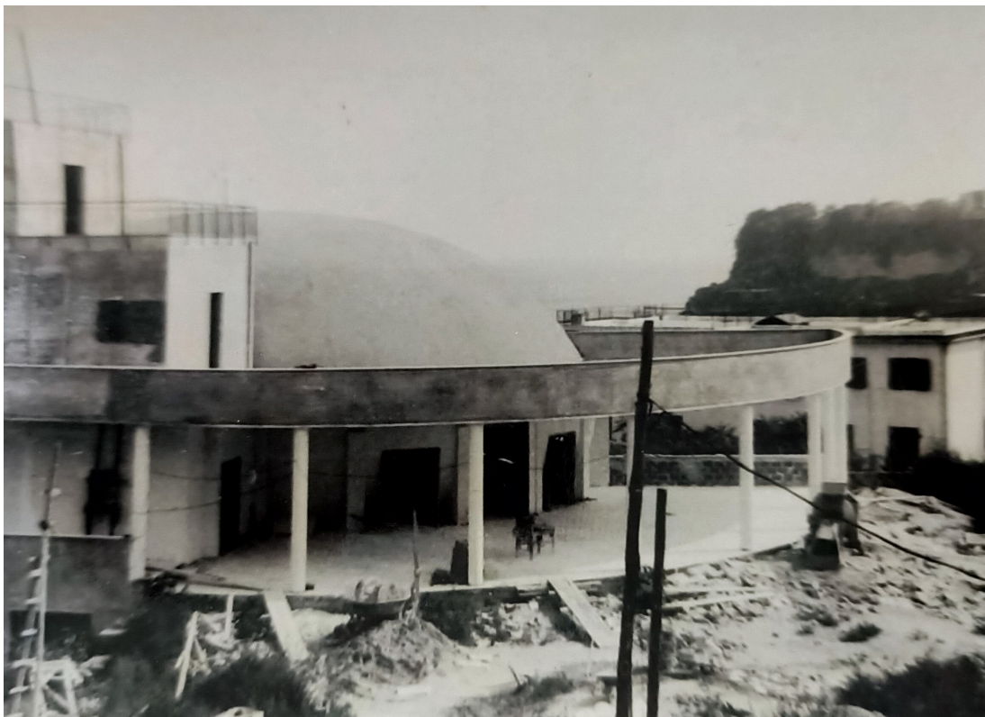
Fig. 10: Cantiere della parrocchia di San Gioacchino, chiesa, 1971-1972 [Bacoli. Archivio parrocchiale di San Gioacchino].
