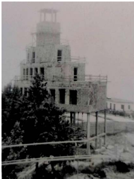
Fig. 8: Cantiere della parrocchia di San Giocchino, casa canonica, 1971-1972 [Bacoli. Archivio parrocchiale di San Giocchino].
