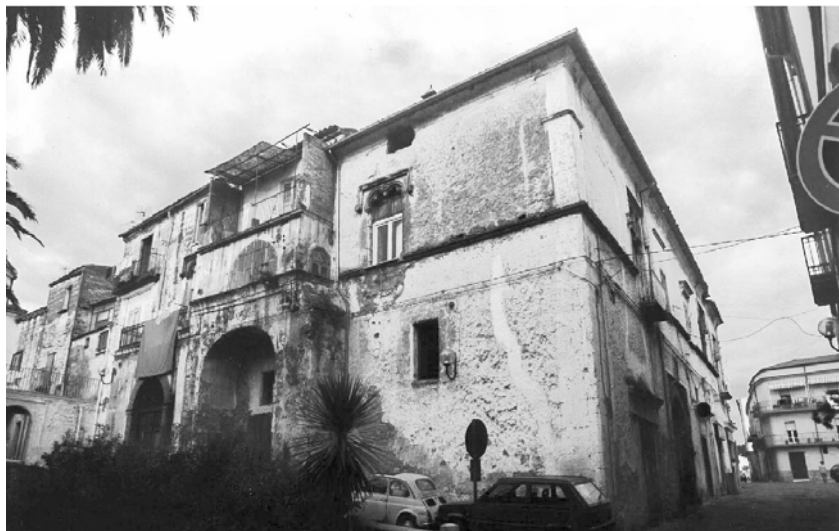
Fig. 10a-b: Palazzo Petrucci prima e dopo il restauro condotto ai primi del XXI secolo (foto degli autori).
